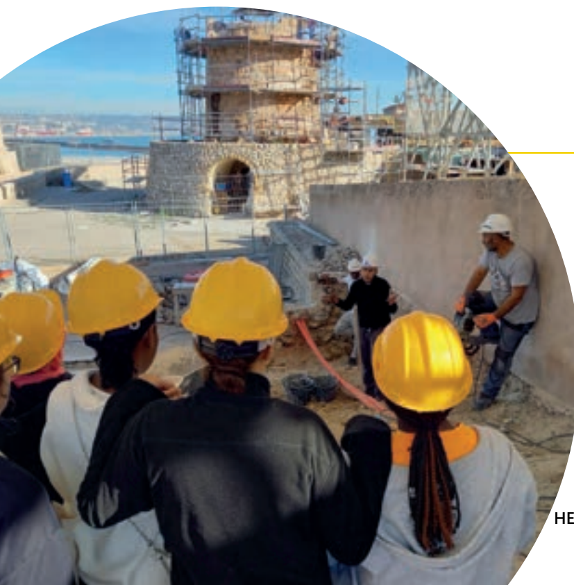
Apprentis expliquant leur travail à un groupe d'enfants visitant le chantier du Fort St Nicolas - Marseille, France
