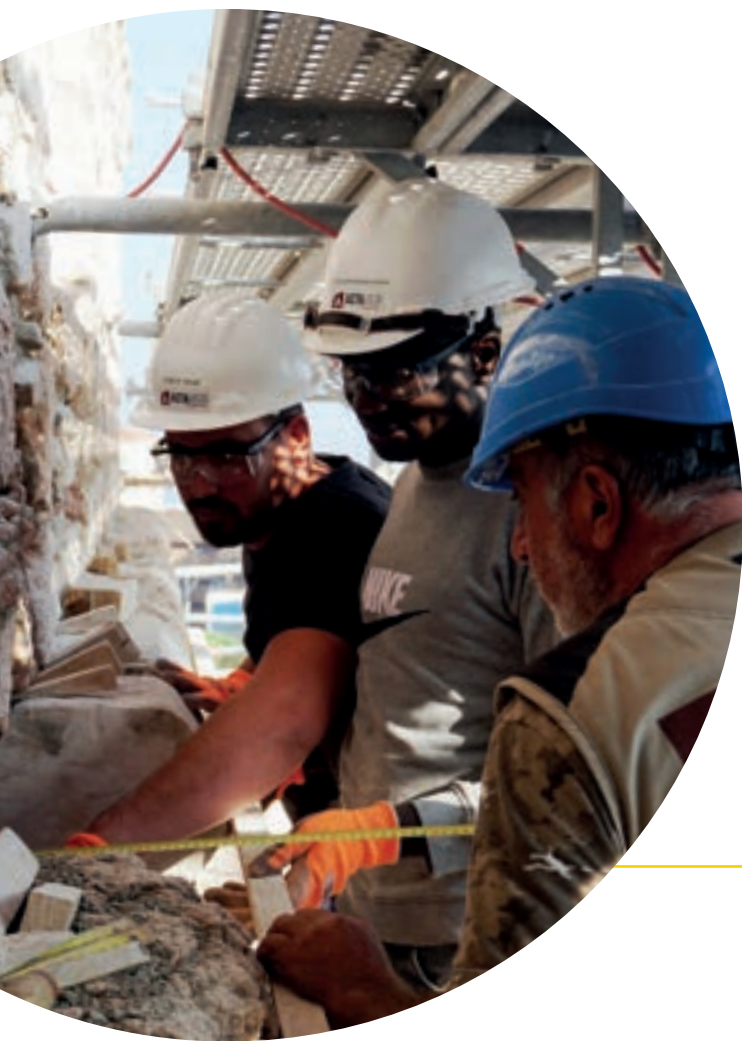
Apprentis et formateur manipulant des pierres sur les murs du Fort Ganteaume - Marseille, France.
